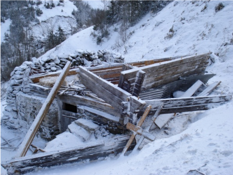
Von der Silberlouwena zerstörte Hütte (Foto: M. Feuz, 17.02.2011).
