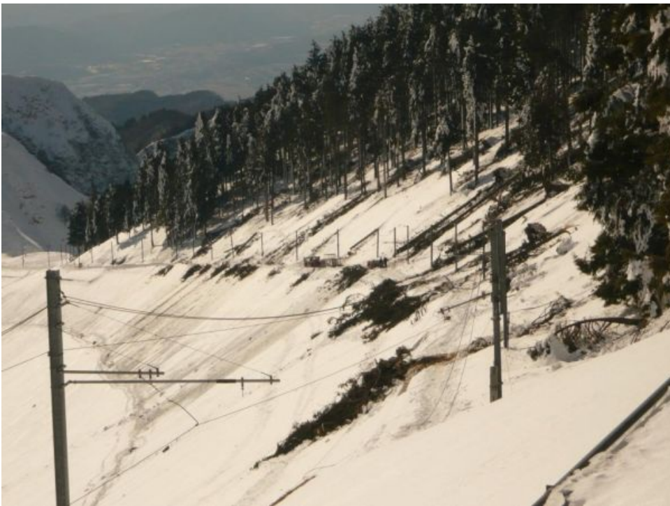
Geknickte Fahrleitungsmasten beim Trasse der Bahn auf den Mte. Generoso, TI (Foto: N. Gobi, 16.02.2009)
