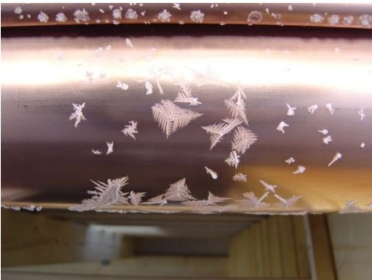
Des Spenglers winterliche Freuden bei der Arbeit. Reifkristalle an einer Kupferdachrinne im Toggenburg (Photo: P.Diener, 21.12.2006).
