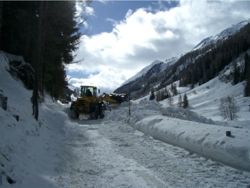
Räumungsarbeiten auf der Dischmastrasse am 10.03., nachdem zwei grosse Lawinen, die durch Variantenfahrer am Brämabühl (2429 m), Gebiet Jakobshorn, GR ausgelöst wurden und bis ins Tal (1600 m) vorstiessen (Foto: SLF/S. Margreth, 10.03.2006).
